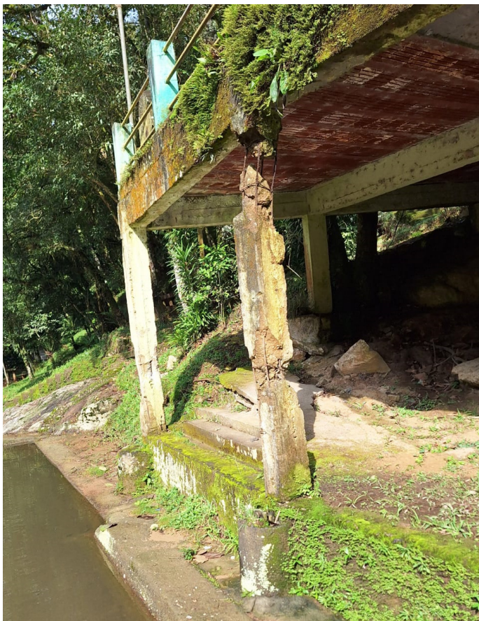
Foto dos pilares 01 (totalmente danificado) e 02 (parcialmente danificado)
