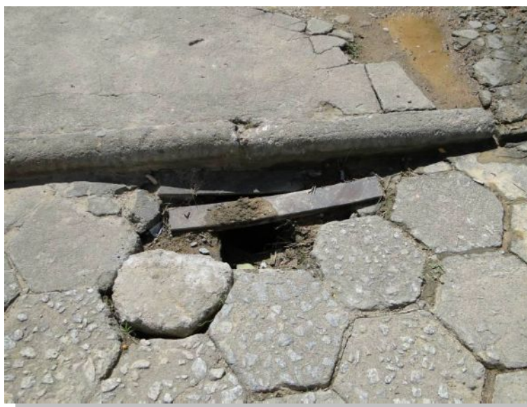
Figura 26 - Boca de Lobo depreciada. Fonte: Visita Técnica STE, 2010.
