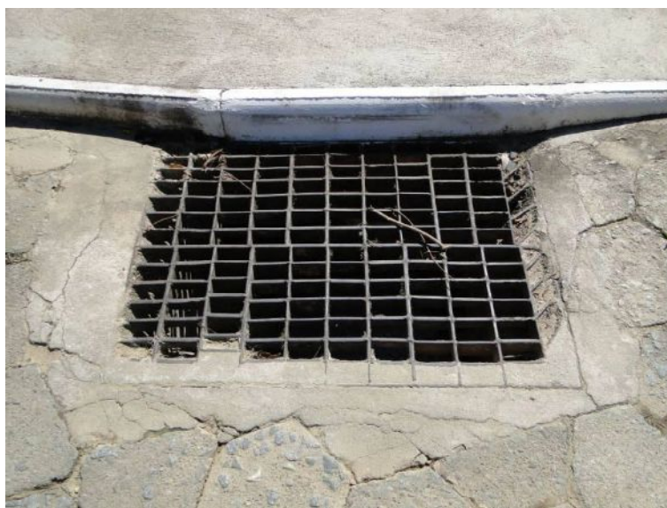
Figura 25 - Sistema de Drenagem Pluvial – Boca de lobo tipo grelha. Fonte: Visita Técnica STE, 2010.
