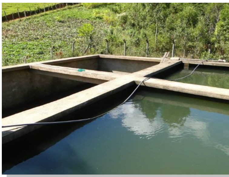
Figura 3 - Filtro Lento de Areia. Fonte: Visita Técnica STE, 2010.
